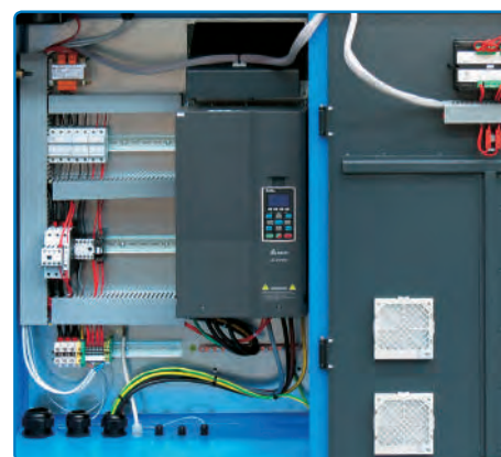
Quadro elettrico e inverter.
