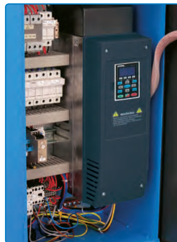
Quadro elettrico e inverter.
