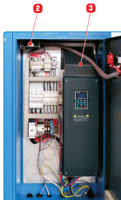
Quadro elettrico e inverter.
